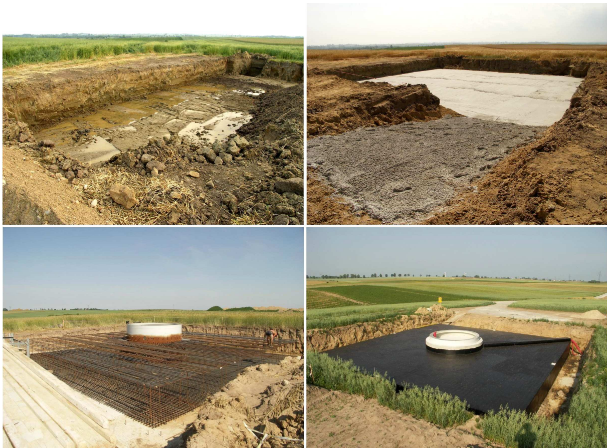
Fot. 7. Etapy powstawania fundamentu elektrowni wiatrowej na przykładzie farmy wiatrowej w Gnieździe
